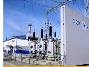
Подстанция 220 кВ Темпы, Московская обл.
